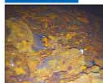
地下タンク内部の腐食状況
