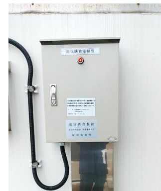
電気防食電源盤
