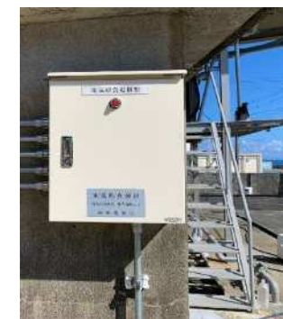
電気防食電源盤
