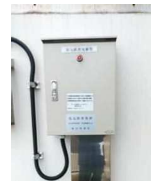
電気防食電源盤
