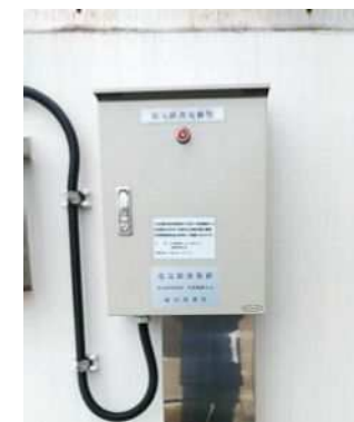
電気防食電源盤
