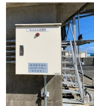
電気防食電源盤
