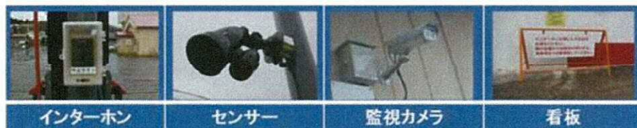
図2 機器の設置状況
