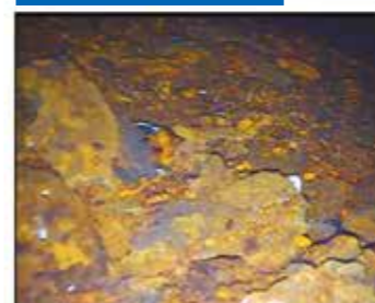
地下タンク内部の腐食状況
